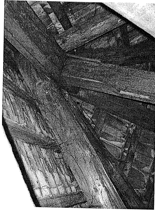
Fotografia 17 Degradacja więźby dachowej
