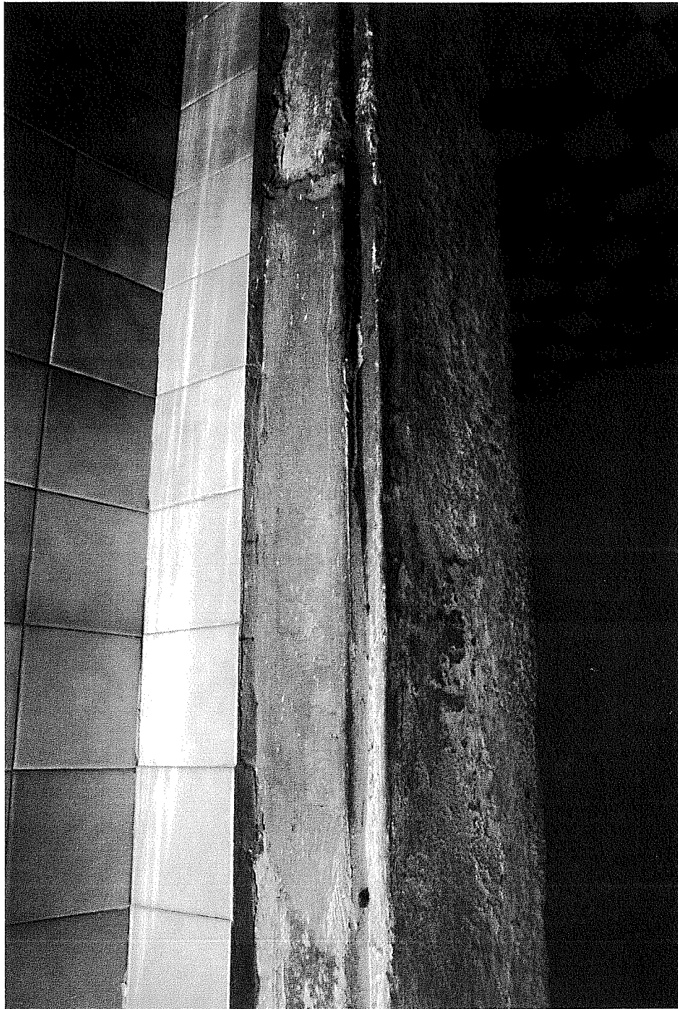
PORTAL KAMIENNY - WIDOCZNE WTÓRNE UZUPEŁNIENIA
