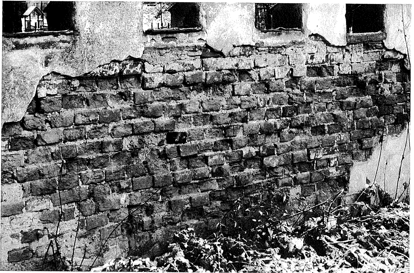
ZNISZCZENIA CEGŁY W PARTII MURU
