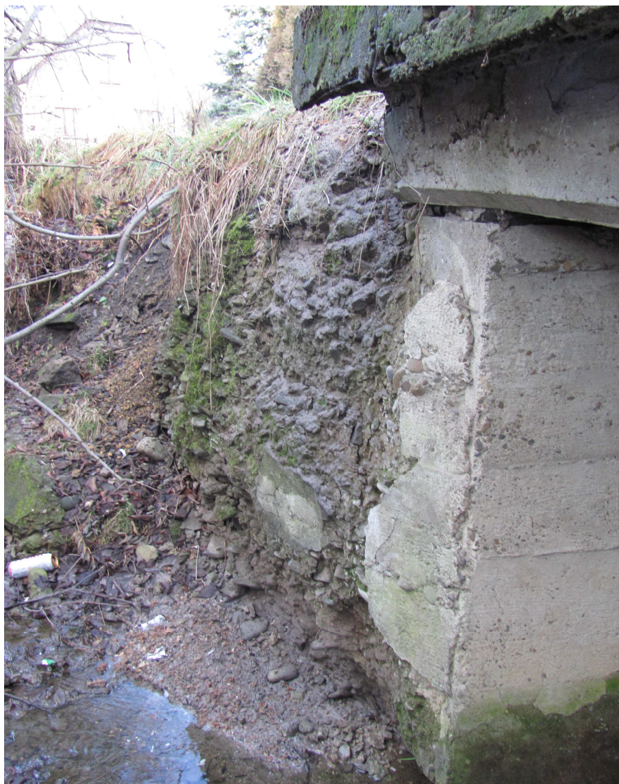
Fot. 5 Uszkodzone skrzydełko lewe od str. górnej wody
