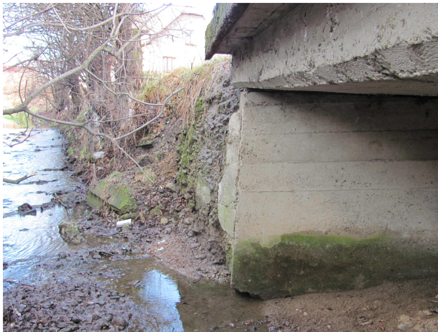
Fot. 5 Podmyty przyczółek lewy, uszkodzenie gzymsu.
