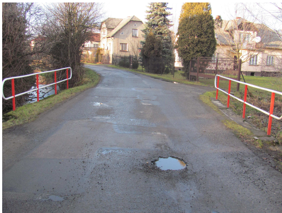
Fot. Uszkodzenie nawierzchni na dojazdach do mostu
