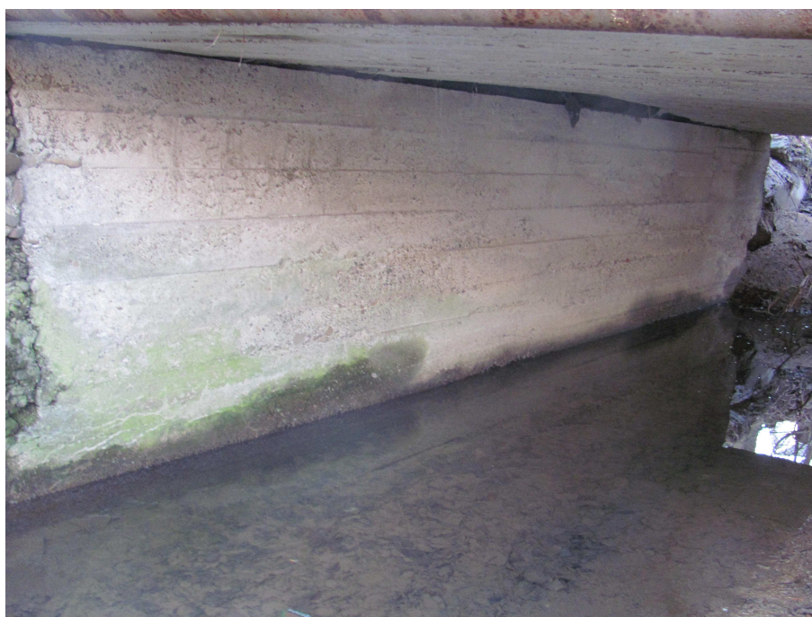
Fot. 5a Podmyty przyczółek prawy
