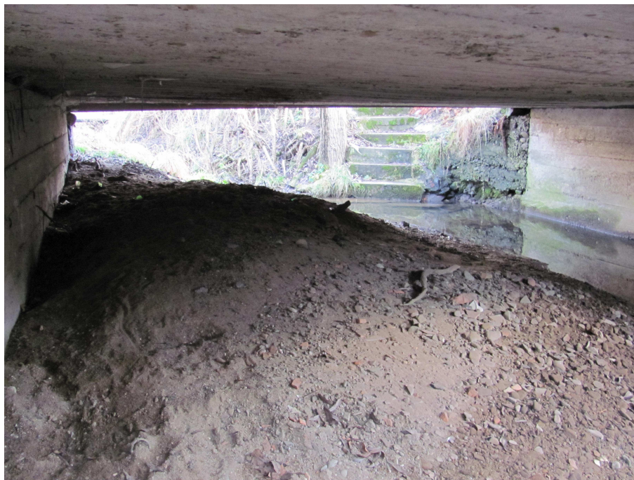
Fot. 7 Nagromadzony grunt w przestrzeni podmostowej – widok w stronę dolnej wody
