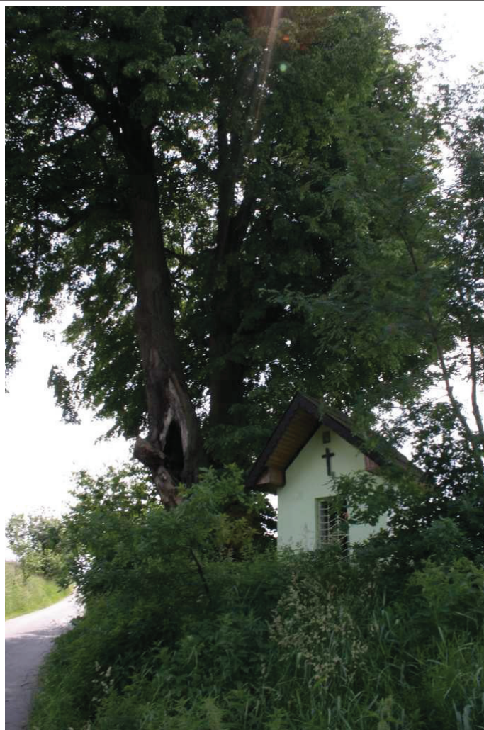
Elewacja frontowa, widoczny zły stan drzewa rosnącego przy obiekcie
