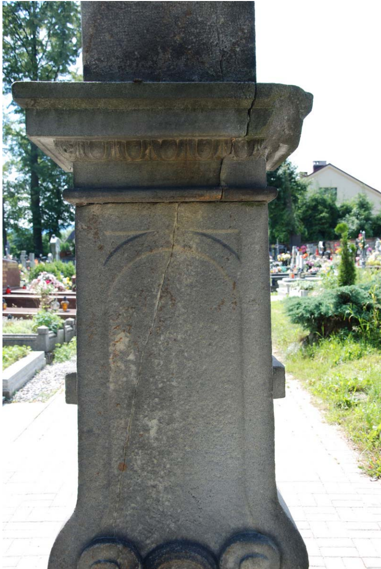
Widoczne poważne rozwarstwienie fragmentów kapliczki
