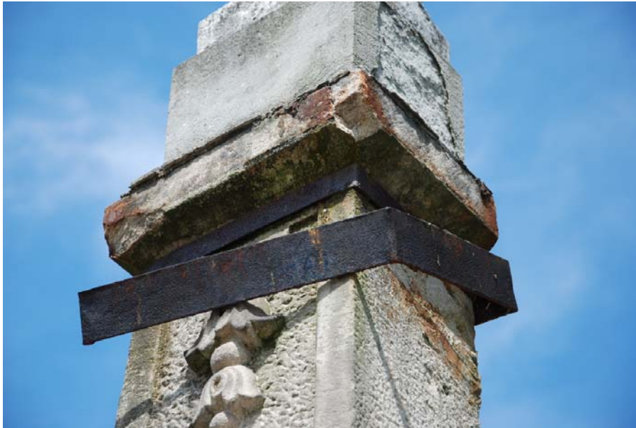
Widoczne uszkodzone wzmocnienie kapliczki słupowej oraz fragmenty uszkodzeń na skutek działania czynników środowiskowych
