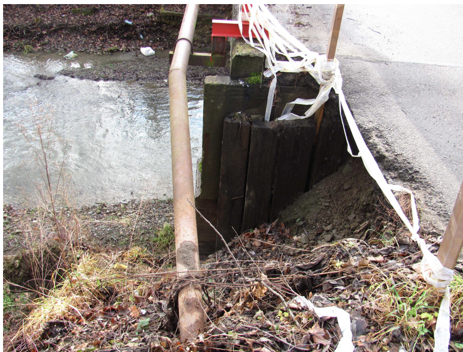
Fot. 6 Uszkodzony stożek nasypu drogowego od strony DK nr 69.
