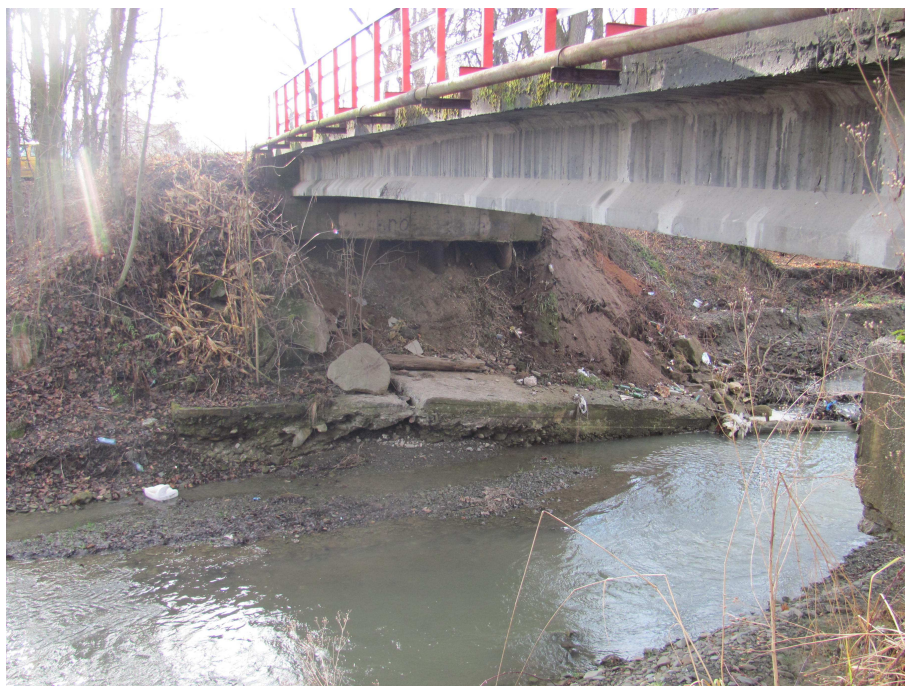
Fot. 4 Lewa podpora, uszkodzona płyta fundamentowa betonowa.
