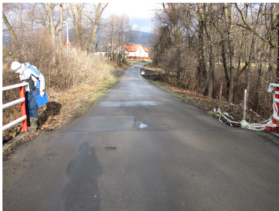
Fot. 9 Widok w stronę DK 69, zdeformowana nawierzchnia.
