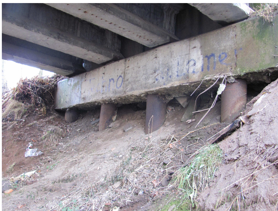
Fot. 5 Prawa podpora, odsłonięte pale stalowe.
