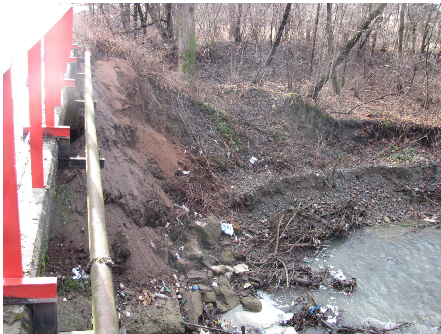
Fot. 7 Brak skrzydełka od str. górnej wody, prawy brzeg w formie osuwiska.
