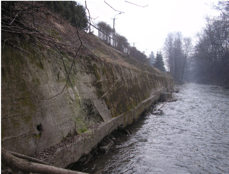
Fot.1.a Widok na uszkodzony podmyty mur oporowy wzdłuż rzeki Żylicza
