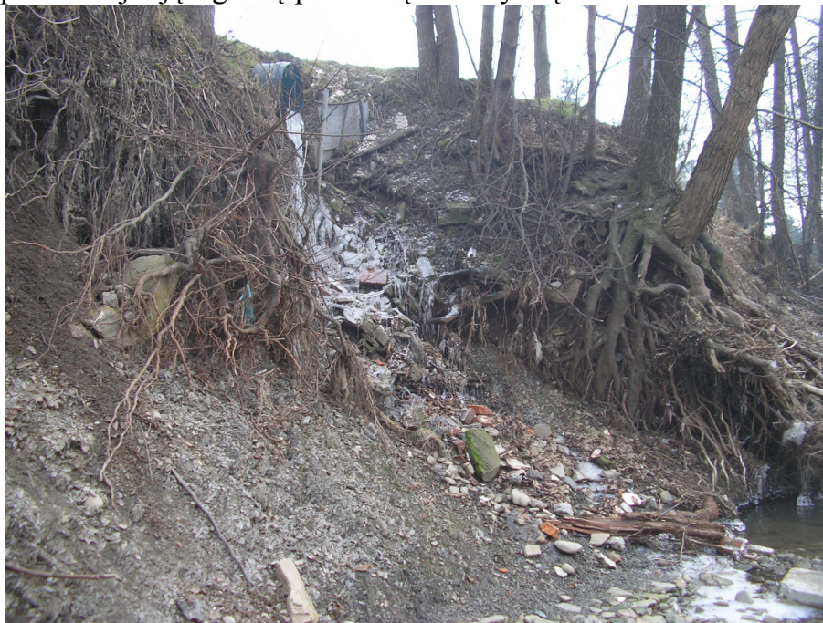
Fot.4. Widok na uszkodzony wylot przepustu
