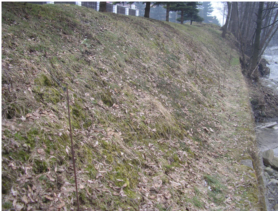
Fot.4b. Brukowanie – od KM 0+229,10 do KM 0+340,00. Brukowanie skarpy rozmyte i porośnięte trawą, wierzch muru oporowego widoczne ubytki.
