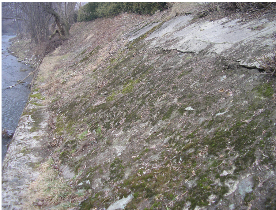
Fot.5a. Brukowanie – od KM 0+229,10 do KM 0+340,00. Brukowanie skarpy rozmyte i porośnięte trawą, wierzch muru oporowego widoczne ubytki.
