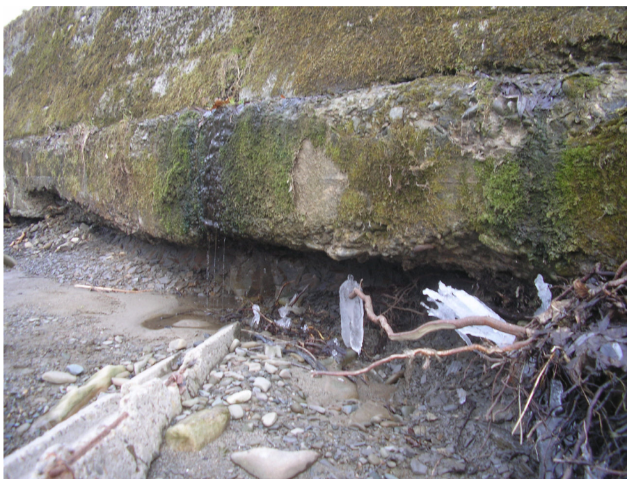
Fot.3a. Mur oporowy KM 0+229,10. Widok uszkodzonej ławy muru oporowego.
