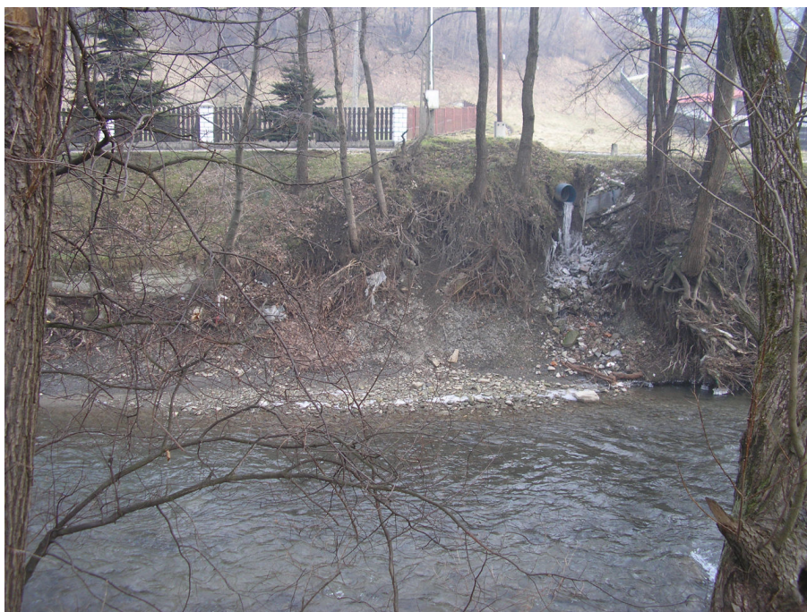
Fot.2. Uszkodzony wylot przepustu pod ulicą Nad Żylicą
