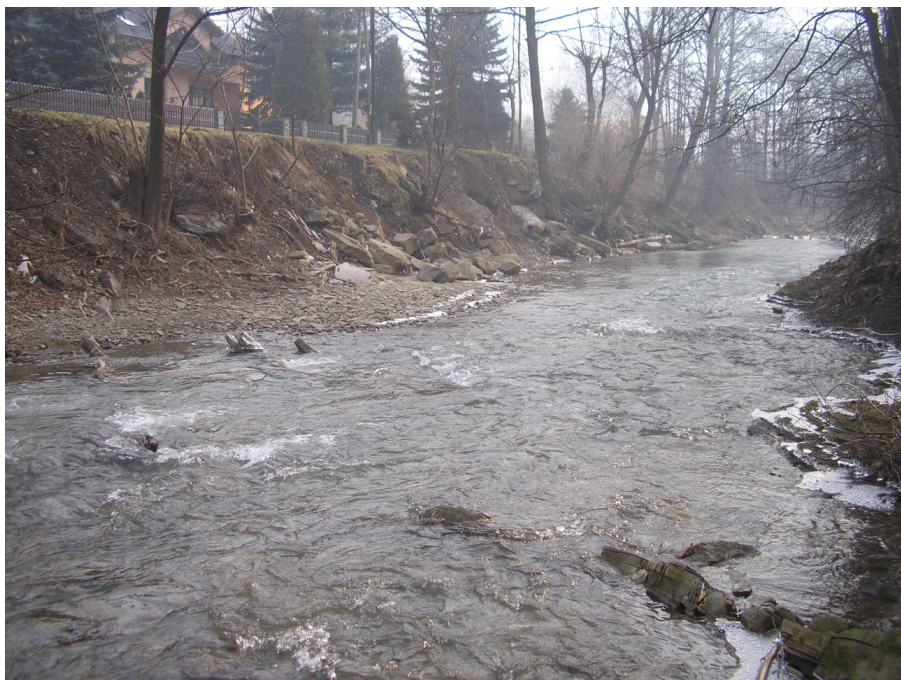
Fot.5. Korpus – od KM 0+150 do KM 0+170,00. Uszkodzona skarpa korpusu ulicy Nad Żylicą.
