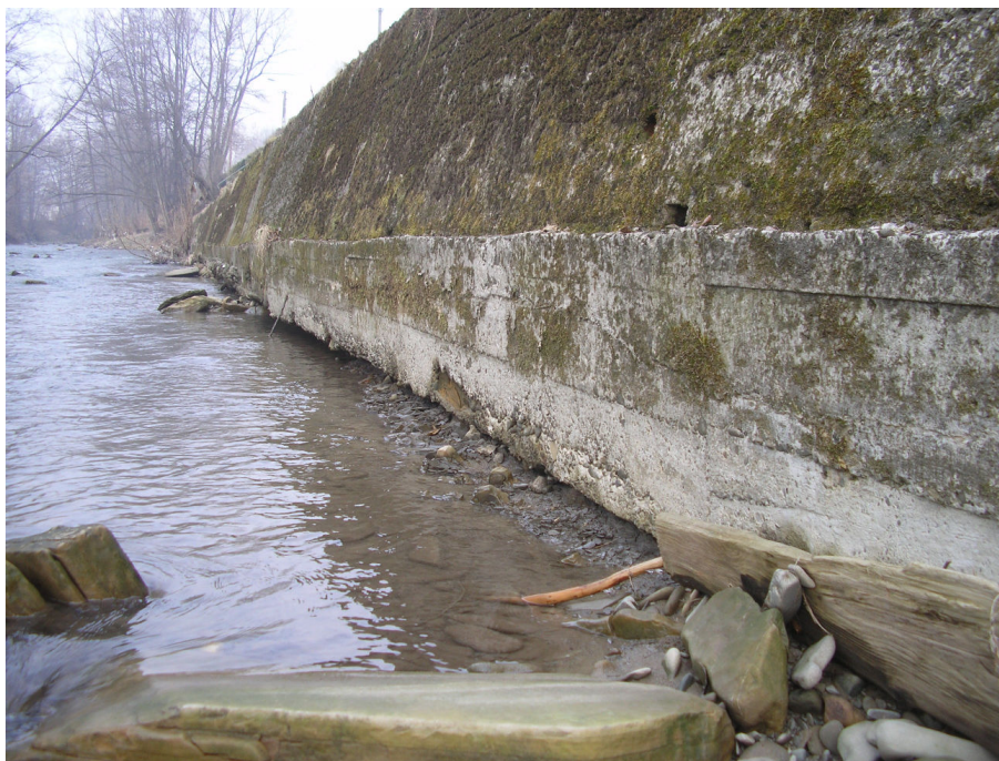
Fot.3b. Mur oporowy – od KM 0+229,10 do KM 0+340,00. Widok na uszkodzony, podmyty mur oporowy wzdłuż rzeki Żylca.
