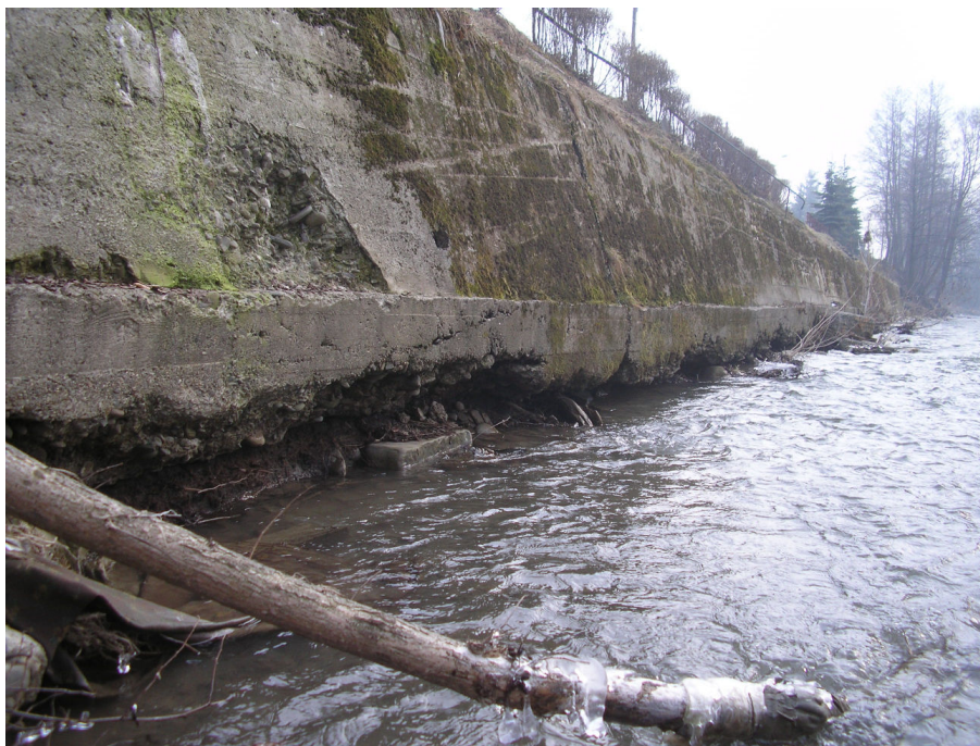
Fot.3. Mur oporowy KM 0+229,10 do KM 0+340. Podmyta ława betonowa muru oporowego na całym odcinku, dł. 110,90 mb.
