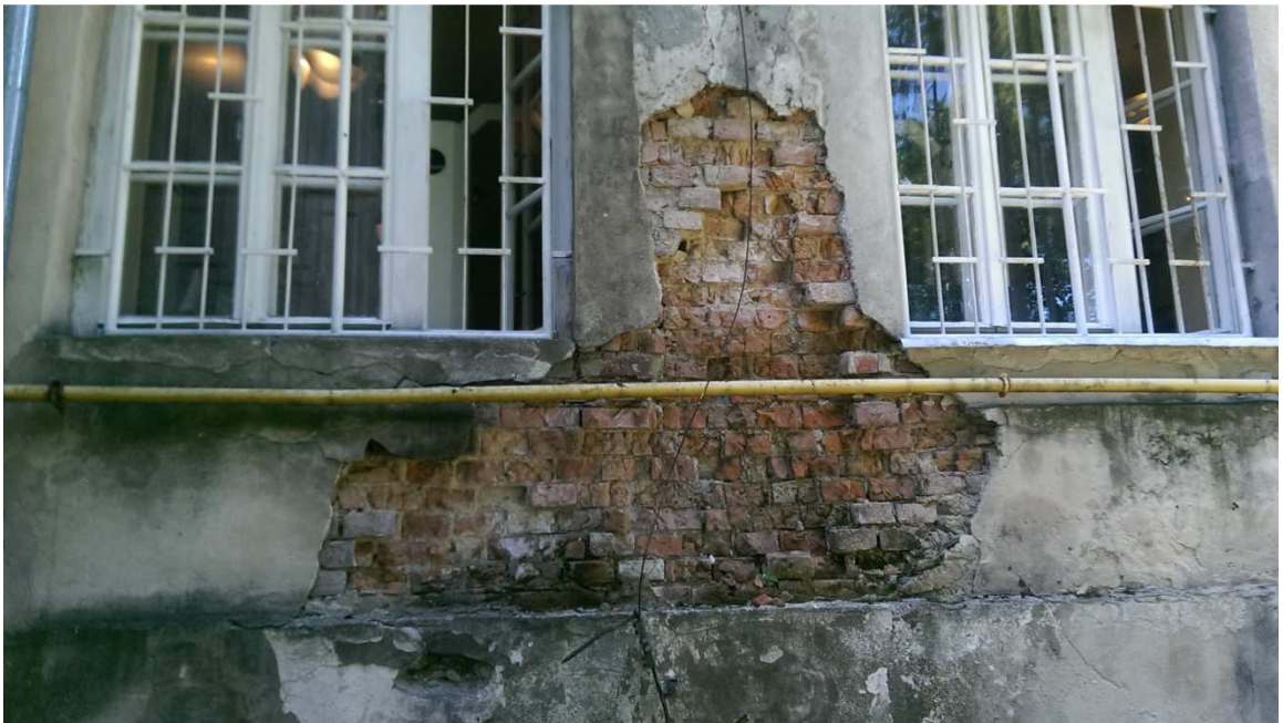
Foto5. Fragment namokniętego i skorodowanego muru:
