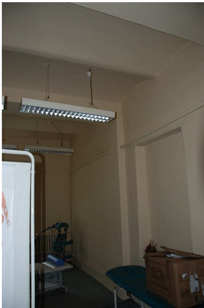
[Fot. 4] Stan techniczny stropów odcinkowych
